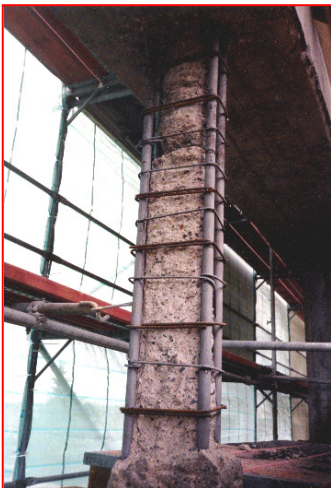
Einbau der Bügelbewehrung, Entrosten der Bewehrung im Zusammenhang mit dem Strahlen, Aufbringen des Korrosionsschutzes
